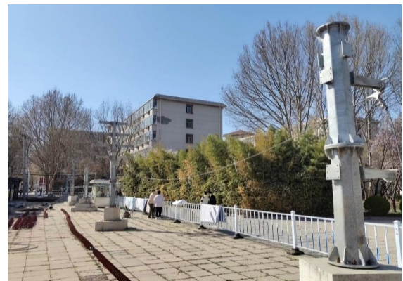
图4 连续档输电线路实验平台
